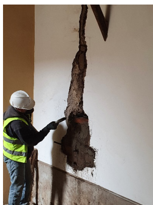
Figura 12 Imagen de cosido y descosido de fisura lado exterior
