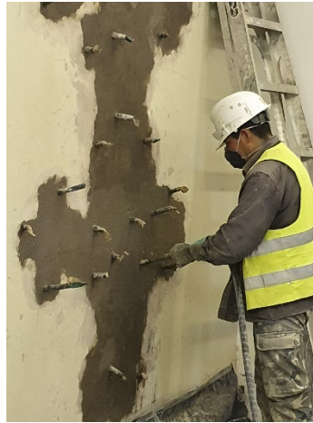
Imagen de proceso de inyectado de mortero con la utilización de pistola de inyectado
