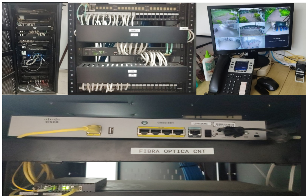
Figura 3 Equipos tecnológicos para Telecomunicaciones
